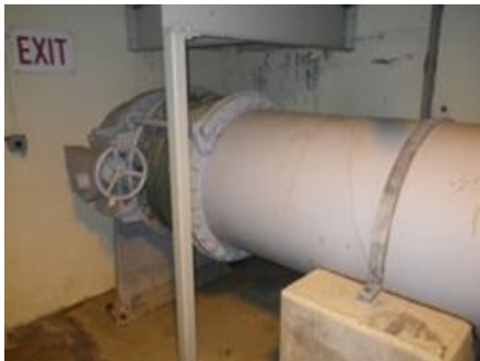
Biotower effluent pipe
